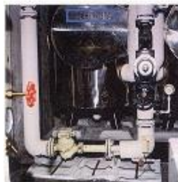
(ビル内の水漏れ)
